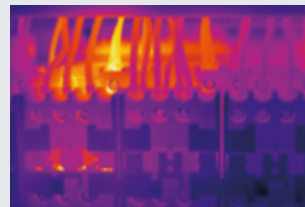
Anlagen instand halten: Zu hohe Temperaturen an Sicherungen und elektrischen Bauteilen erkennen bevor es zu Ausfällen kommt.
